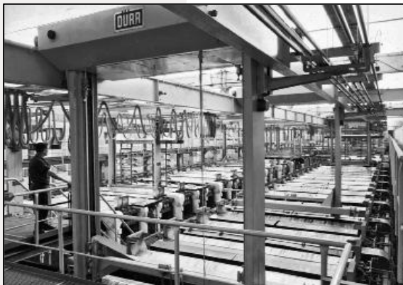
Abb. 6: Stohrer und die Firma Dürr richteten gemeinsam die VW-Galvanik mit Galvanoautomat in Brasilien Anfang der 1960er-Jahre ein.
